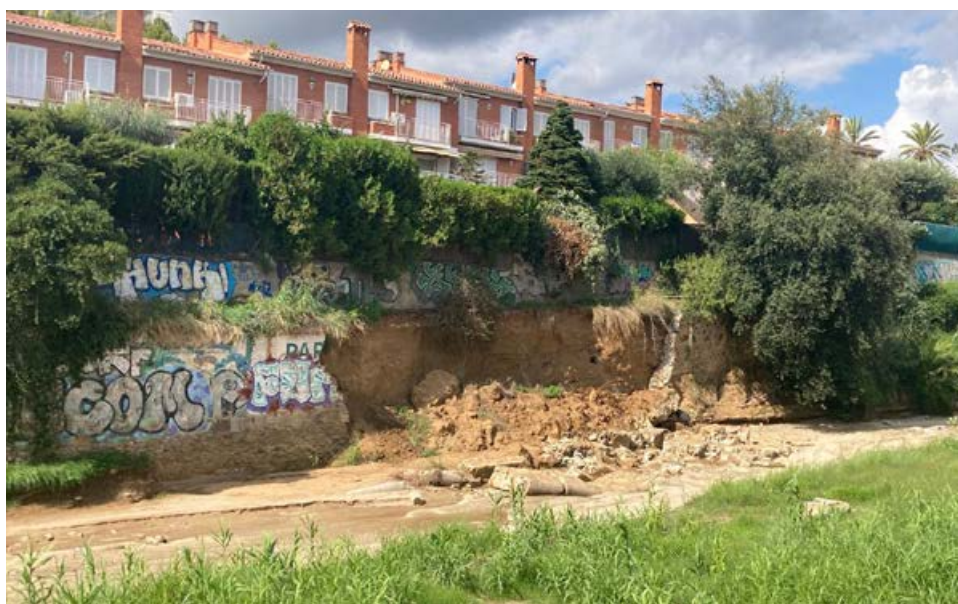
Mur a la desembocadura de la riera d'Alella el 2 de setembre de 2025, després d'una riuada. Damunt hi ha les cases del passatge de la Riera.
